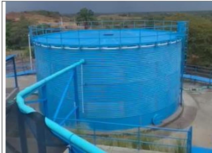
Foto 3. Tanque de Almacenamiento
